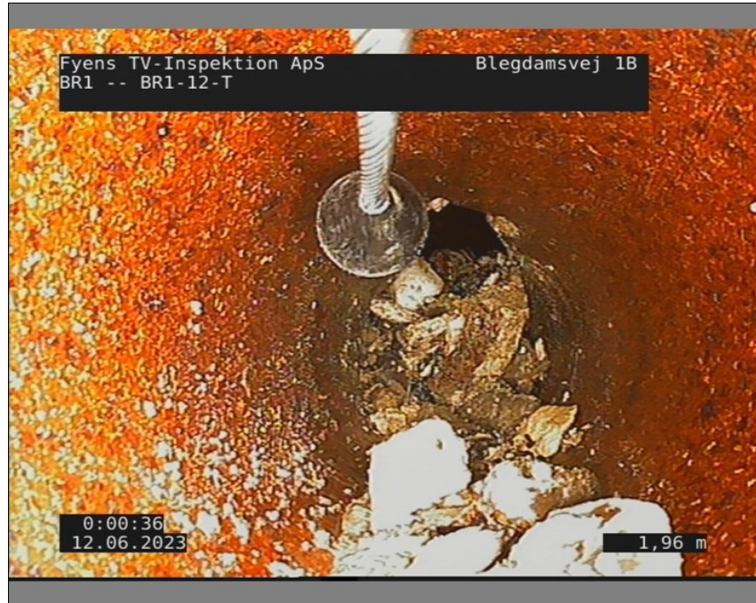
Foto: 1_3A, Medie #: 12062023, 00:00:37 2m, Overfladebeskadigelse klasse 3, fra urref 0 til urref 12
