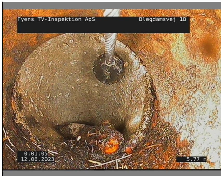
Foto: 5_9A, Medie #: 12062023, 00:01:05 5,8m, Overfladebeskadigelse klasse 3, fra urref 0 til urref 12
