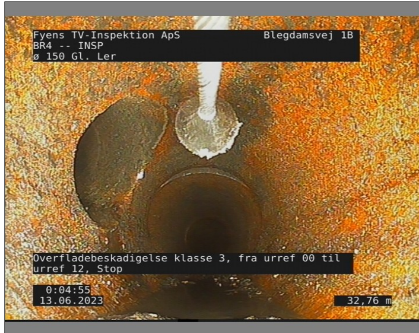
Foto: 17_14A, Medie #: 12062023, 00:04:56 32,8m, Overfladebeskadigelse klasse 3, fra urref 00 til urref 12, Stop
