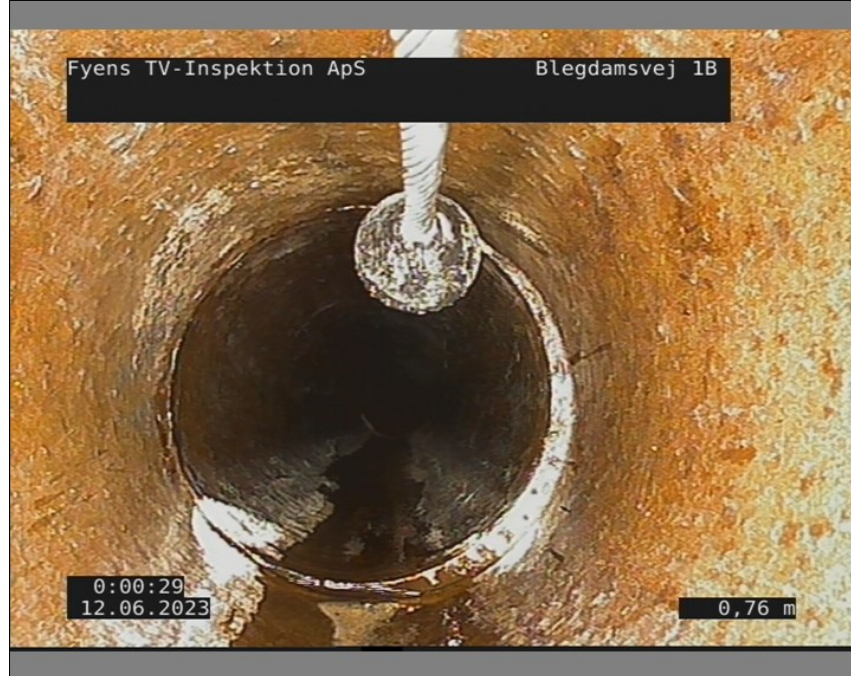
Foto: 2_4A, Medie #: 12062023, 00:00:29 0,8m, Overfladebeskadigelse klasse 3, fra urref 0 til urref 12, Start
