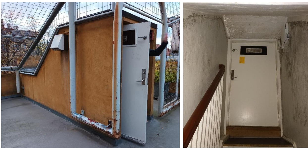
Figur 1 – Toppen af trappetårnet mod Tømrergade udefra (venstre foto) og indefra (højre foto). Indefra ses kondens i venstre side af loftet af trappetårnet og skimmelsvamp på væggene i begge sider.
