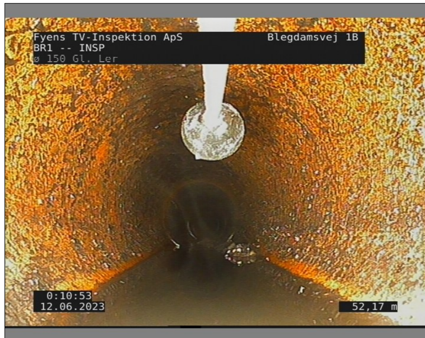
Foto: 2_35A, Medie #: 12062023, 00:10:53 52,2m, Overfladebeskadigelse klasse 3, fra urref 00 til urref 12, Stop
