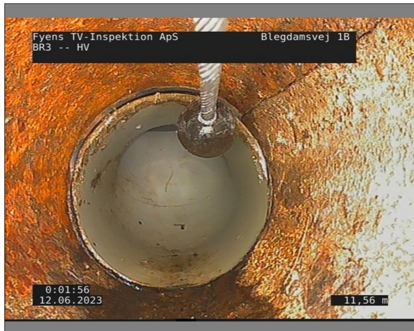
Foto: 4_11A, Medie #: 12062023, 00:01:57 11,6m, Overfladebeskadigelse klasse 3, fra urref 00 til urref 12, Stop
