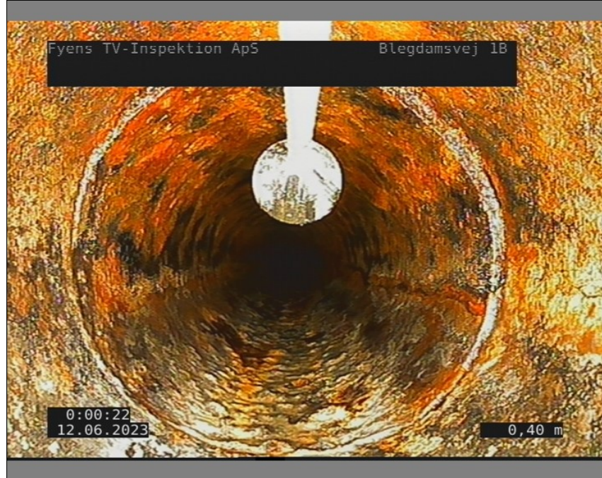
Foto: 13_3A, Medie #:: 12062023, 00:00:22 0,4m, Overfladebeskadigelse klasse 3, fra urref 0 til urref 12, Start
