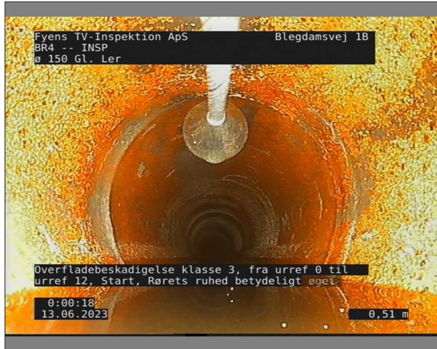
Foto: 17_3A, Medie #: 12062023, 00:00:18 0,5m, Overfladebeskadigelse klasse 3, fra urref 0 til urref 12, Start
