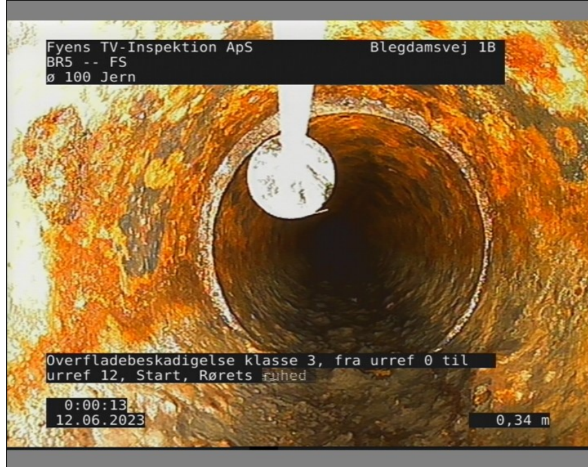
Foto: 12_3A, Medie #: 12062023, 00:00:14 0,3m, Overfladebeskadigelse klasse 3, fra urref 0 til urref 12, Start
