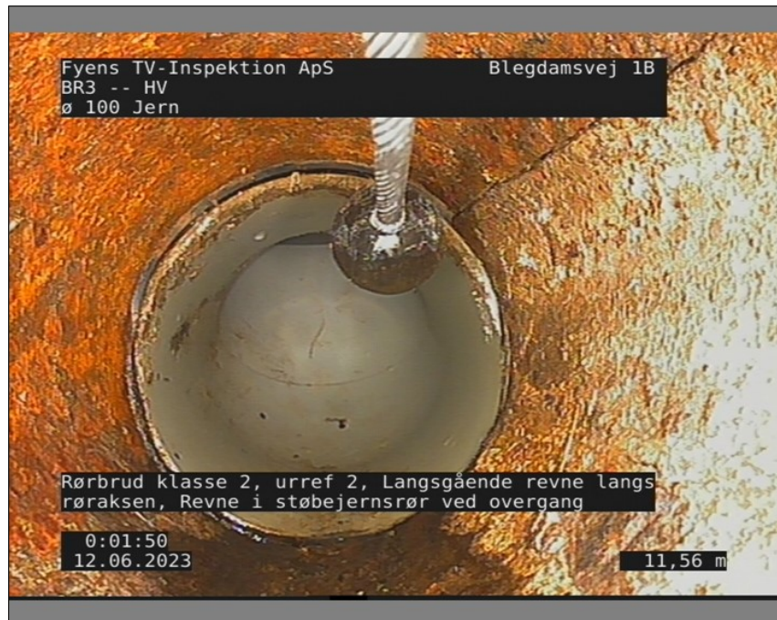
Foto: 4_9A, Medie #: 12062023, 00:01:48 11,6m, Rørbrud klasse 2, urref 2, Langsgående revne langs røraksen
